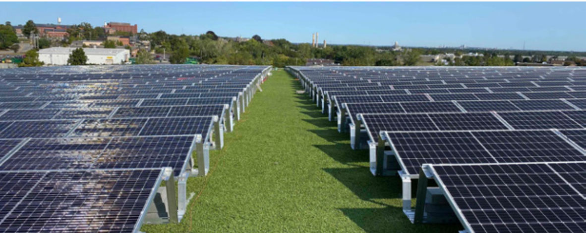
PARC SOLAIRE BEACON Rhode Island, États-Unis Partenaire: Power Sustainable Energy Infrastructure
